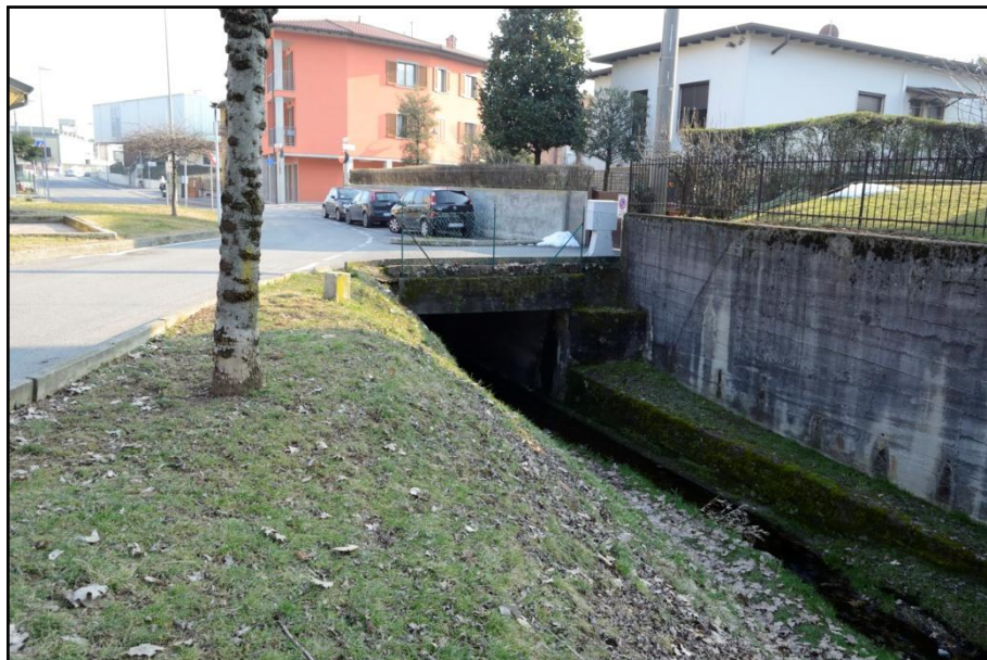
Figura 13 – L’imbocco del tombotto del Torrente Riolo all’altezza della chiesetta dei Mortini
