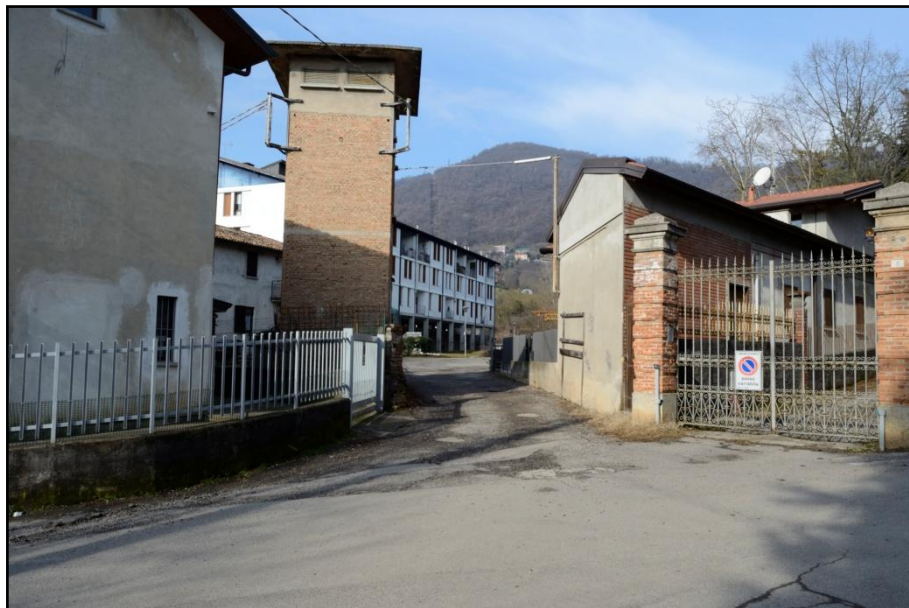
Figura 7 - Cabina di trasformazione elettrica all'inizio di Via Zanino Colle
